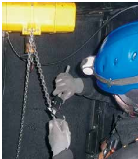
Überprüfung von Lastketten der Elektrohebezeuge
